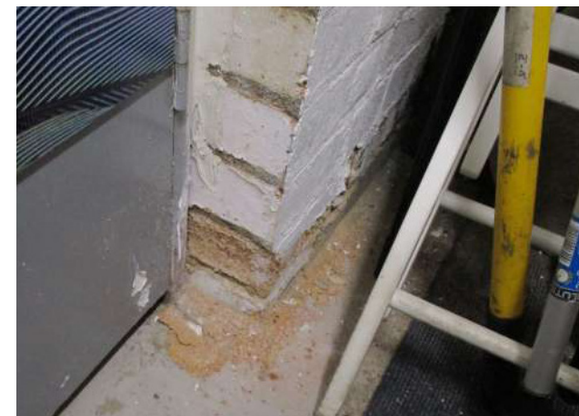
Fan Room Store
