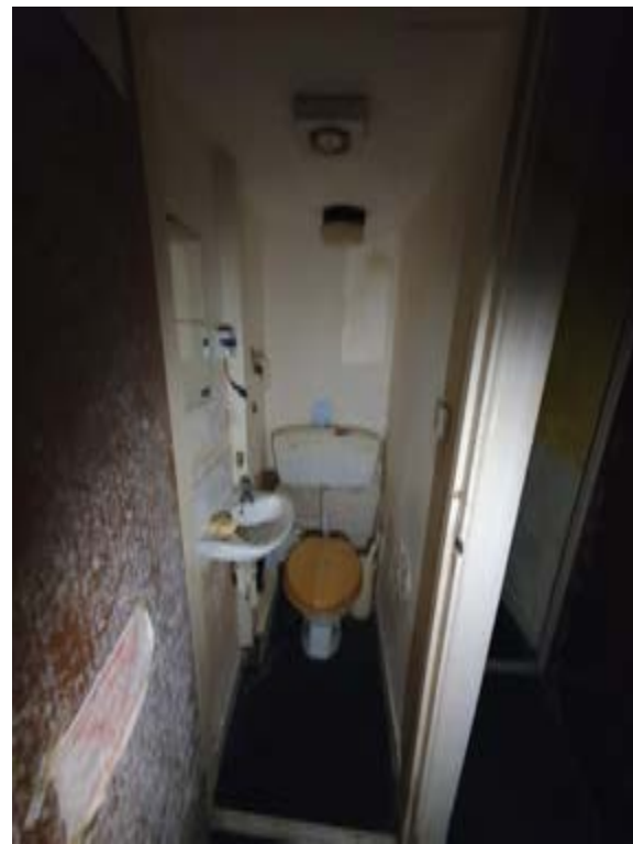
Photo108 – B06 - Basement WC - Door DB1
