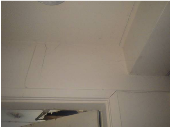
17. Fracturing above door
